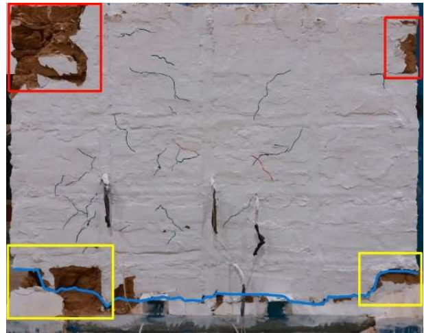
شکل ۱۲. الگوی ترک خوردگی و شکست نمونه ی W0.1S2 Fig. 12. Cracking pattern and damage status in W0.1S2
