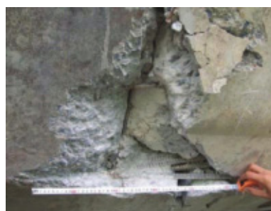
الف) ترک عمیق در شاه تیر اصلی
